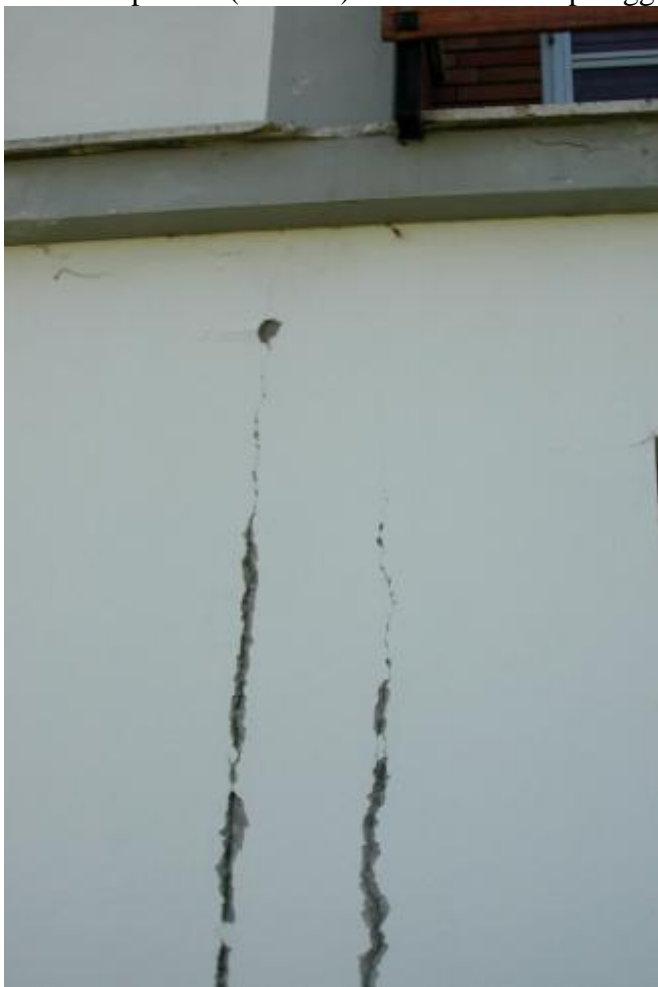
Foto 3 - Spinello (S. Sofia): distacco fra pilastro e tamponature in edificio in c.a.
