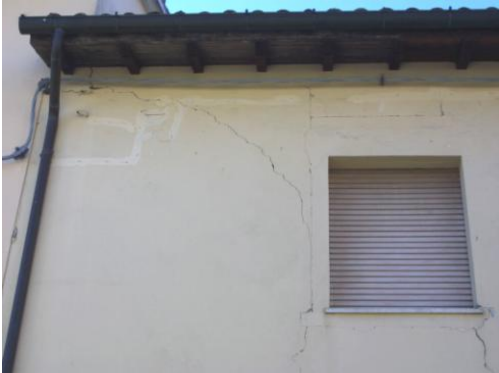
Foto 4 - Spinello (S. Sofia): lesioni su edificio in muratura.
