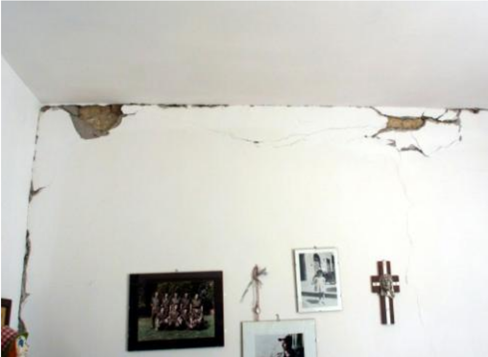
Foto 5 - Spinello (S. Sofia): lesioni interne e caduta intonaco su un edificio in muratura nel centro storico.
