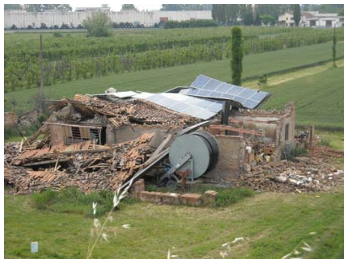
Foto 4 – Cascinale crollato nelle campagne. Molto numerosi sono stati i crolli totali o parziali di edifici di questo tipo nell'area epicentrale.
