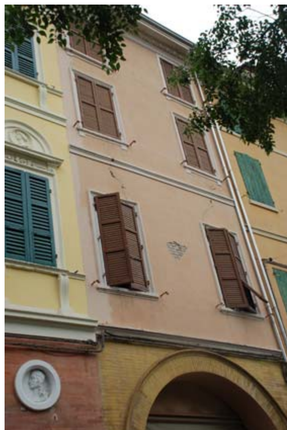
Foto 2 – Mirandola Danno di grado 2 ad edificio di tipo B
