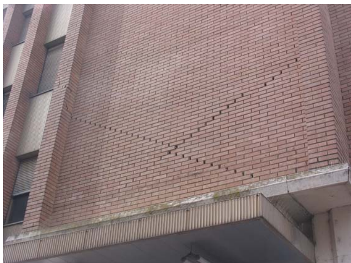
Foto 3 - Cavezzo. Danno di grado 3 in edificio di cemento armato
