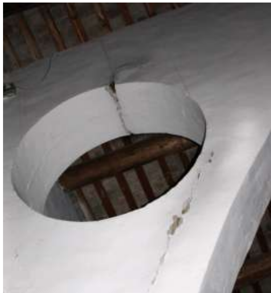
Foto 3 - Colorno (PR), lesioni nell'edificio storico dell'Aranciaia.
