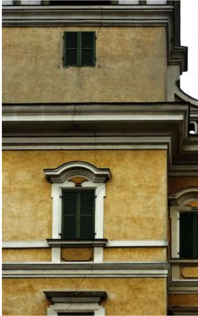
Foto 2 - Colorno (PR), lesioni murarie alla Reggia.
