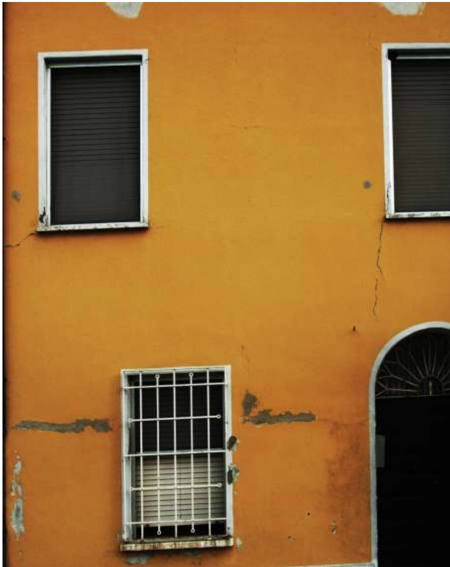
Foto 1 - Pomponesco (MN). Leggere lesioni in edificio in muratura.
