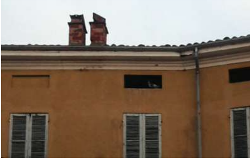
Foto 4 - Parma, caduta di mattoni da un camino nel centro storico.
