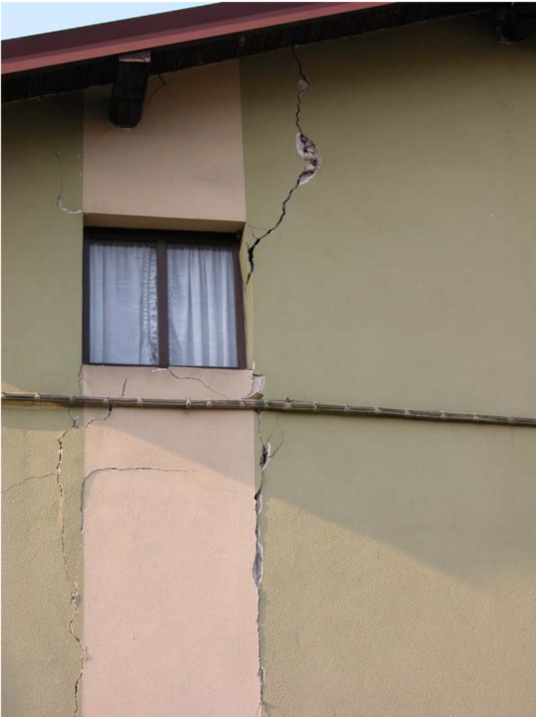
Foto 11 - Pompegnino (BS): lesione passante su edificio in muratura
