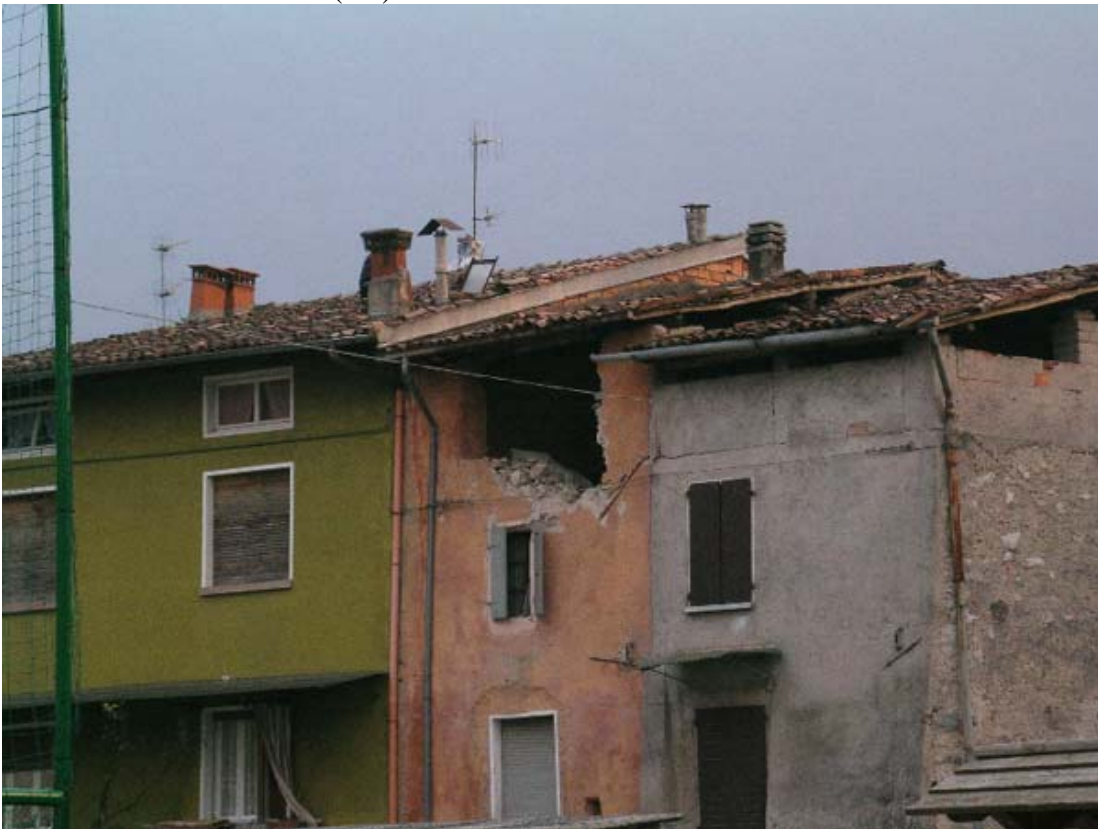
Foto 6 - Clibbio (BS): crollo parziale di edificio fatiscente
