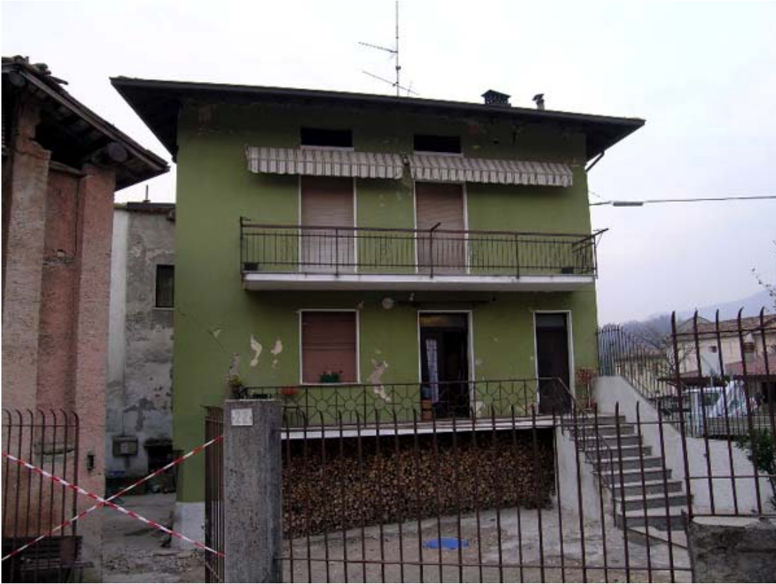
Foto 7 - Clibbio (BS): lesioni passanti a un edificio in muratura
