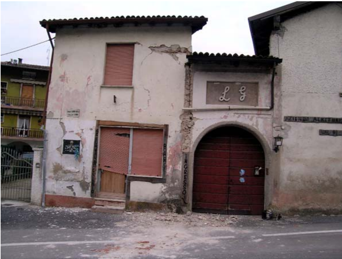
Foto 9 - Clibbio (BS): lesioni gravi a edificio in cattive condizioni
