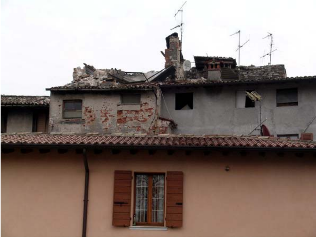
Foto 3 - Salò (BS): crollo parziale di porzione di edificio fatiscente
