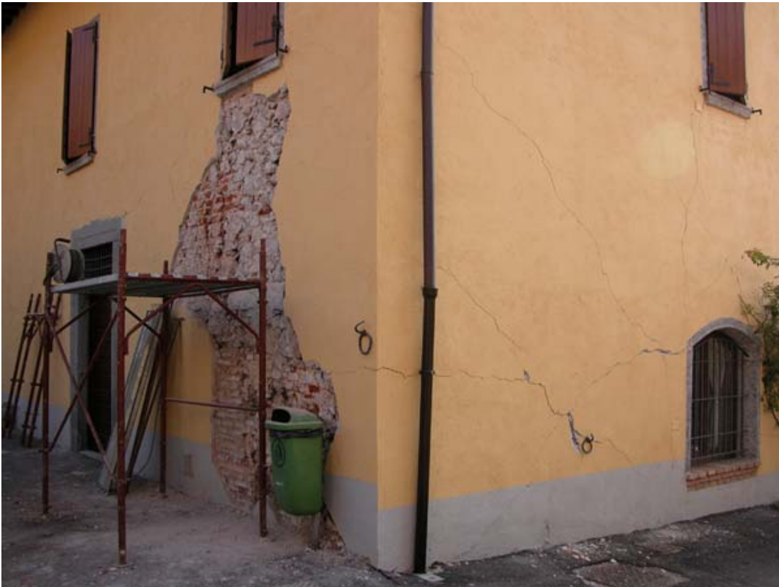
Foto 12 - Pavone (BS): lesione passante su edificio in muratura
