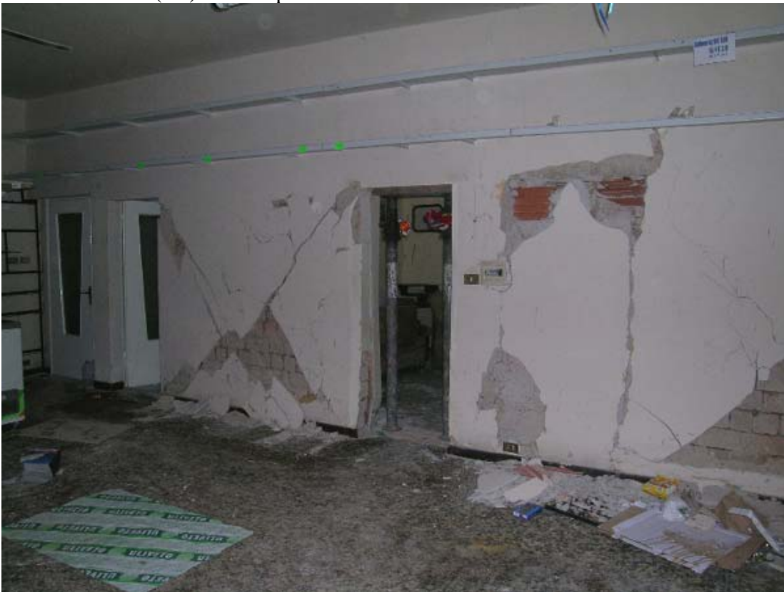
Foto 8 - Clibbio (BS): lesioni interne a edificio in muratura, appesantito da coperto in c.a.
