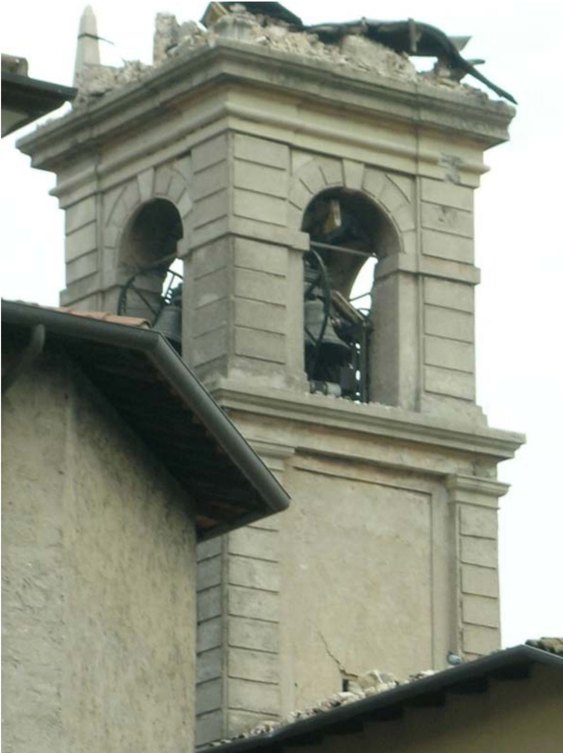
Foto 2 - Salò (BS): crollo della parte sommitale della cella campanaria di S. Bernardino
