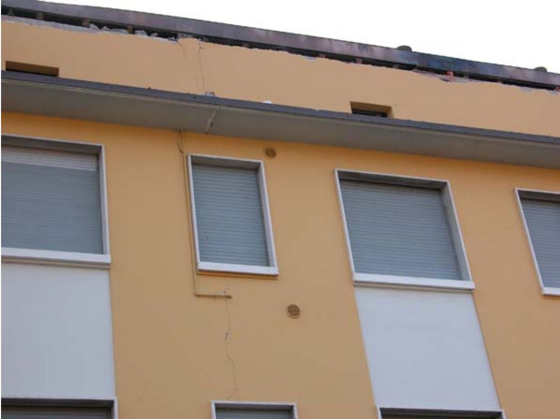
Foto 13 - Sabbio Chiese (BS): crollo di cornicione
