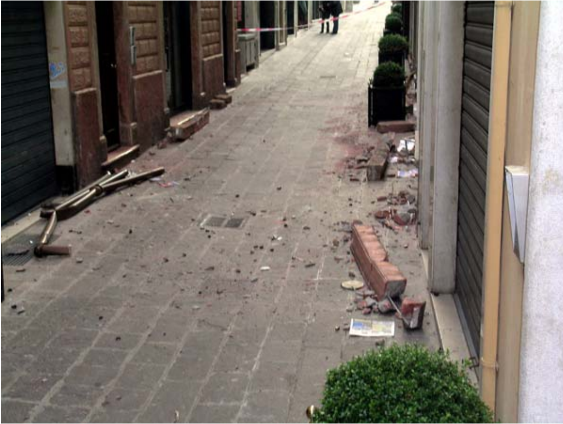
Foto 5 - Gardone Riviera (BS): crollo isolato di cornicione nel centro storico
