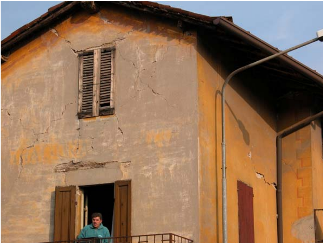
Foto 14 - Roè Volciano (BS): lesioni passanti su edificio in muratura
