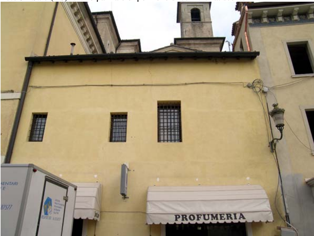
Foto 4 - San Felice del Benaco (BS): lesioni passanti a un edificio del centro storico
