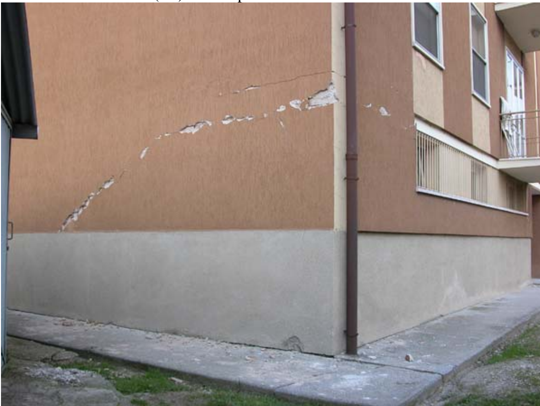
Foto 15 - Roè Volciano (BS): lesioni a edificio in c. a.
